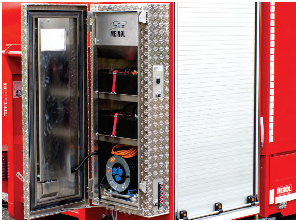
Abbildung 13: Detail – Zentraler Stirn-Schaltschrank, sehr hochwertige Ausführung mit 2 Verschlüssen und groß dimensionierter Gummidichtung. Der MEINDL-Schaltschrank ist von uns speziell für diesen Einsatzzweck konstruiert!
