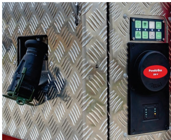
Abbildung 33: Stromeinspeisung PowAirBox, alternatives Bedienteil inomatic®.
