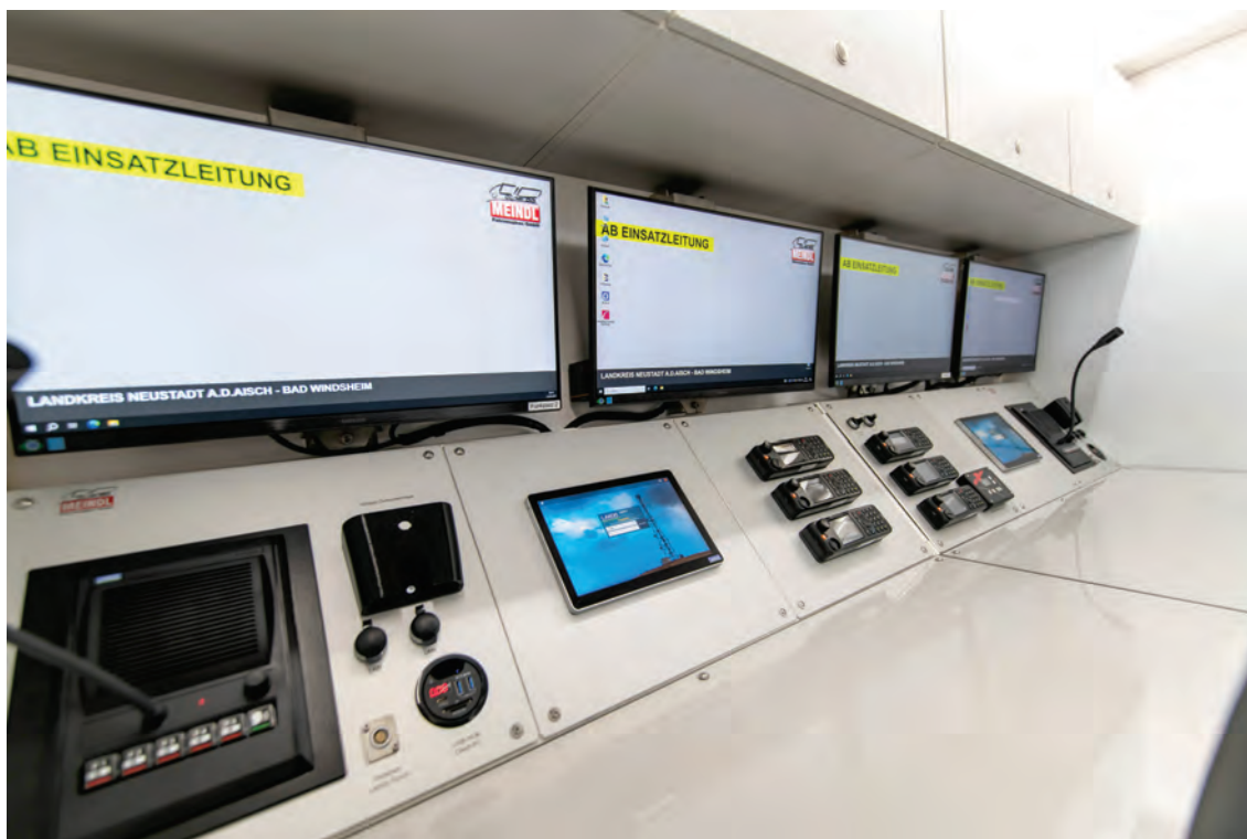
Abbildung 19: Detail – AB ELW 2 Kommunikationsraum: Doppel-Funkarbeitsplatz.
