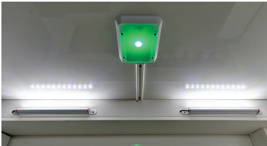
Abbildung 40: Lichtkörper der indirekten Beleuchtung und separate Nachtbeleuchtung (hier mit Grünlicht).
