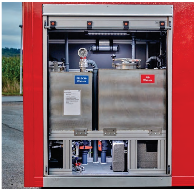
Abbildung 55: MEINDL-Edelstahl-Hauswasseranlage in separatem, abgeschottetem Hauswasserraum mit Zugang über seitlich montierten Rollladen.
