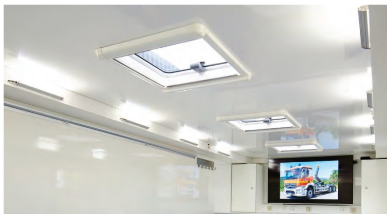
Abbildung 39: Blendfreie Beleuchtung durch indirektes Licht.
