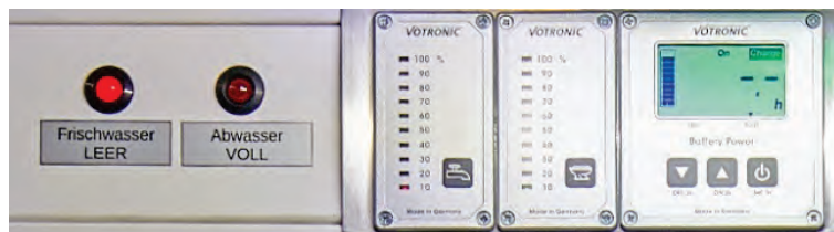
Abbildung 56: Überwachungspaneel der Hauswasseranlage und der Batterieanlage im AB.
