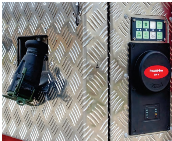
Abbildung 43: Stromeinspeisung PowAirBox, alternatives Bedienteil inomatic®.
