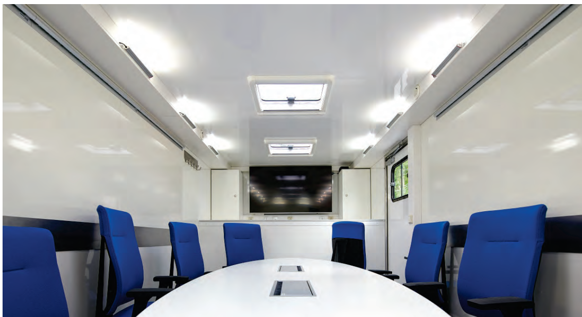
Abbildung 66: Kombinierte Luftführungskanäle im Dachbereich, hier sind auch die Lichtelemente der indirekten Beleuchtung montiert. Weiterhin dient der Kanal ggf. als Kabelkanal für Strom und EDV. Durch diese Bauweise sind nachträgliche Erweiterungen problemlos möglich.
