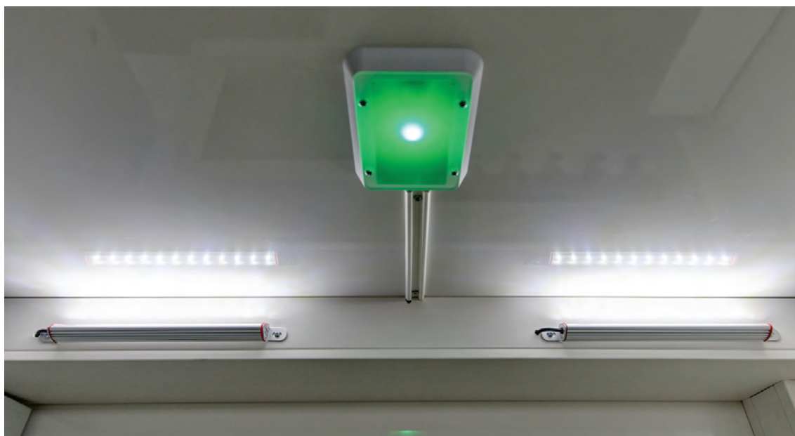
Abbildung 51: Lichtkörper der indirekten Beleuchtung und separate Nachtbeleuchtung (hier mit Grünlicht) und sichtbarer Kabelverlegung (optional ist eine Verkabelung der Deckenleuchten in Leerrohren darstellbar).
