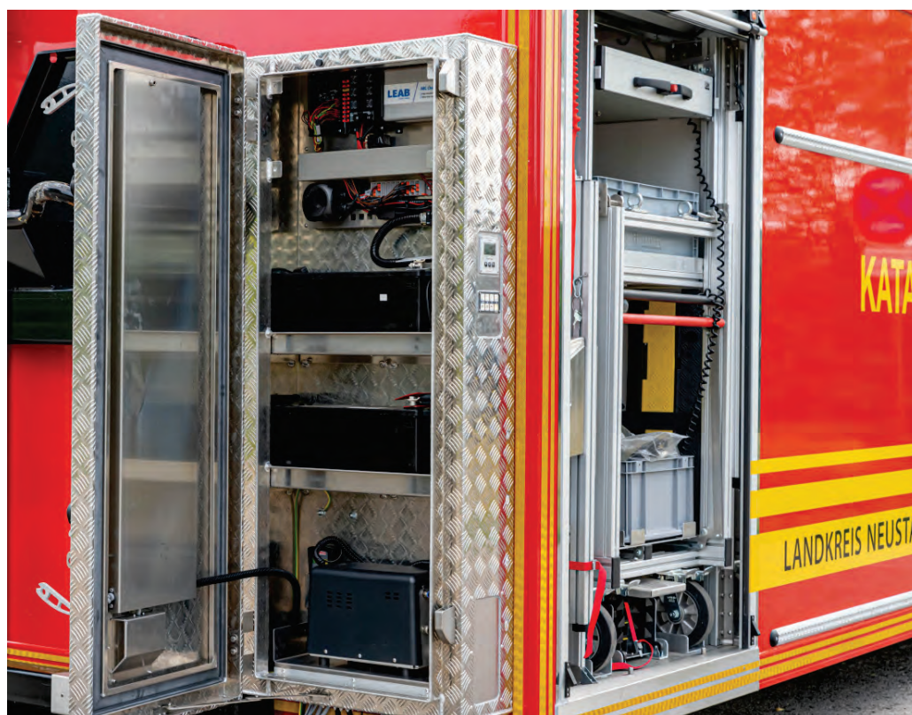
Abbildung 33: Detail – Zentraler Stirn-Schalterschrank, sehr hochwertige Ausführung mit 2 Verschlüssen und groß dimensionierter Gummidichtung. Der MEINDL-Schalterschrank ist von uns speziell für diesen Einsatzzweck konstruiert!
